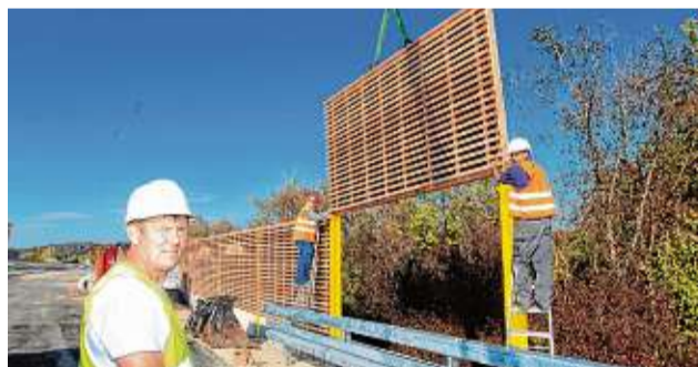
Die letzten Vorbereitungen am neuen Teil der Eisenbahnbrücke: Levente Bango, Christoph Böhm und Fitze Richard (von links) stellen eine Lärmschutzwand auf. BILD: OLIVER HANSER
